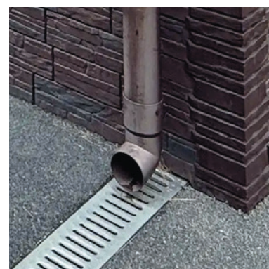
Нет зазора между панелью и отстойкой.
