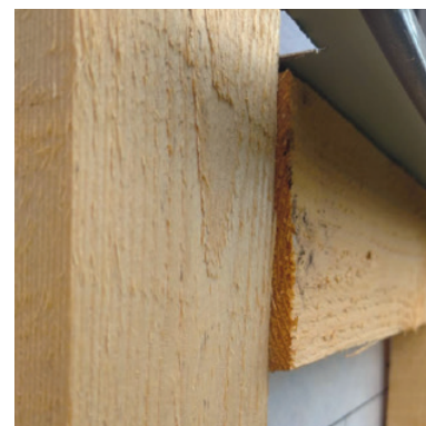
Обрешетка не в плоскости. Перекрыт вентиляционный канал.
