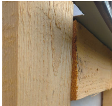
Обрешетка не в плоскости. Перекрыт вентиляционный канал
